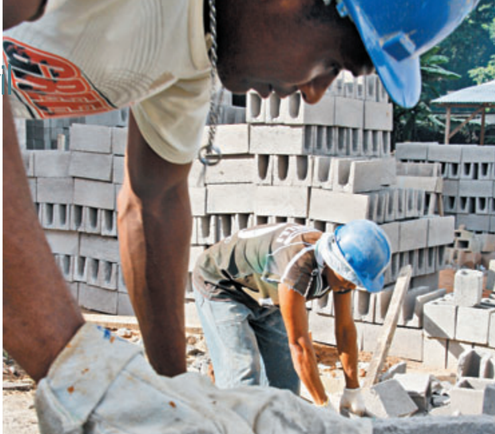
• O fim do período de chuvas já deixou os canteiros de obras mais movimentados
